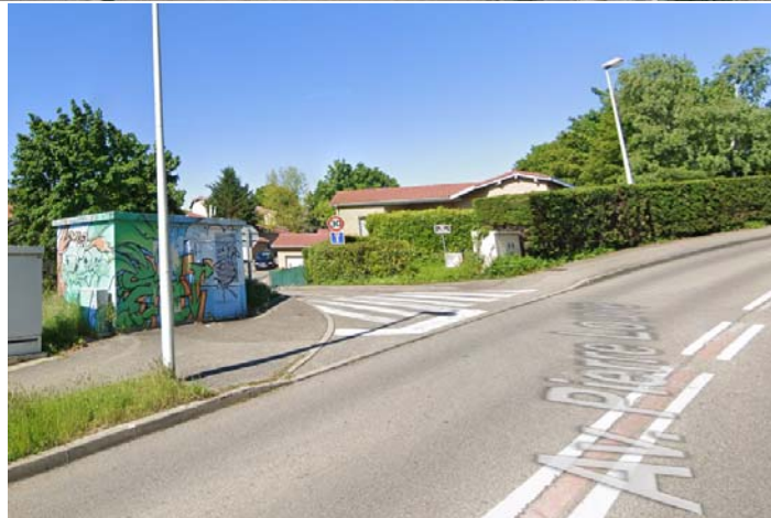
Bloc électrique à l'entrée de la rue des Carrières
